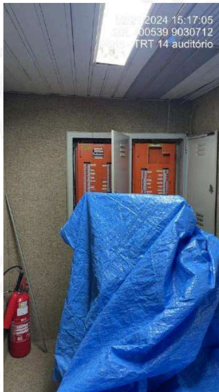
Figura 1 - Quadros de distribuição existentes
